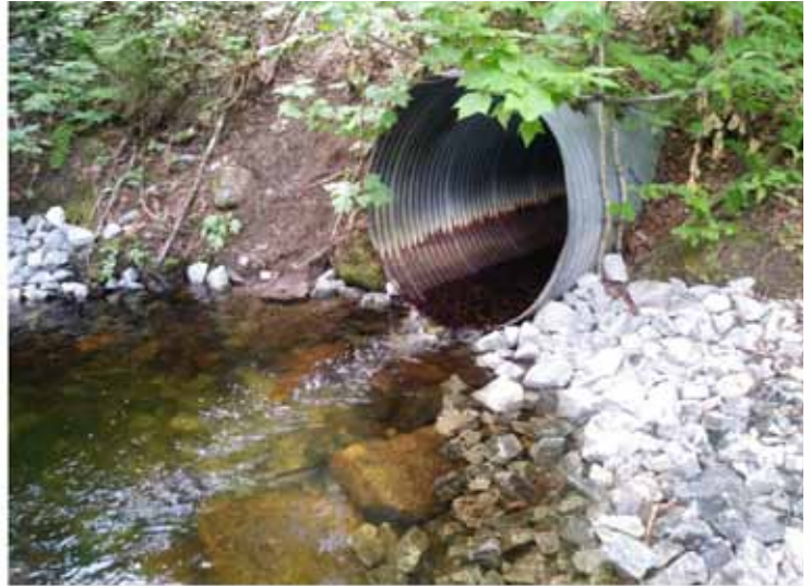
Figure 3 : Rehaussément d'un tuyau en oval d'un ponceau sur la rivière Éternité permettant l'accès à l'anguille d'Amérique. Photo : Alian Gros-Louis Picard
